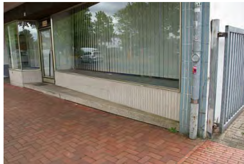
Gebäude mit Sanierungsbedarf
