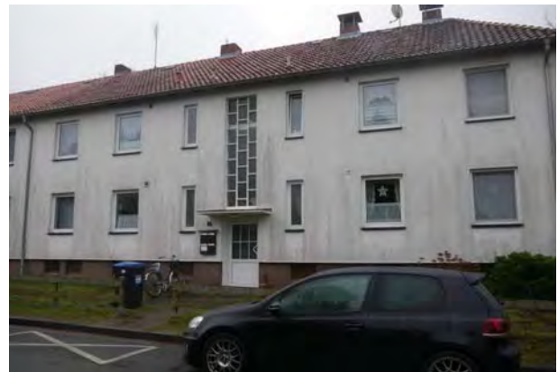
Abb. 11: Sanierungsbedarf Fassade Upaltenweg
