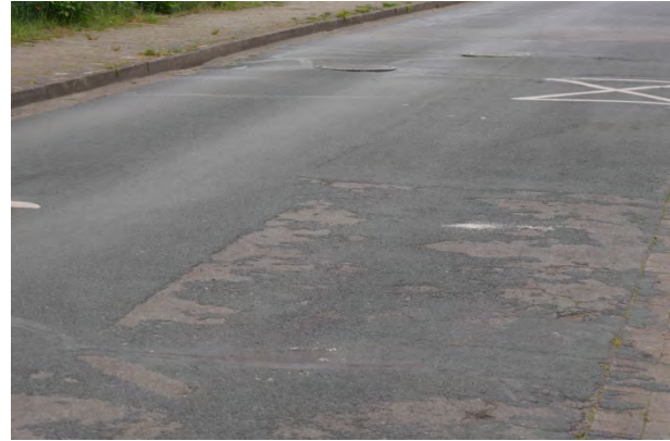
Abb. 79: Schlechter Fahrbelag im Upaltenweg
