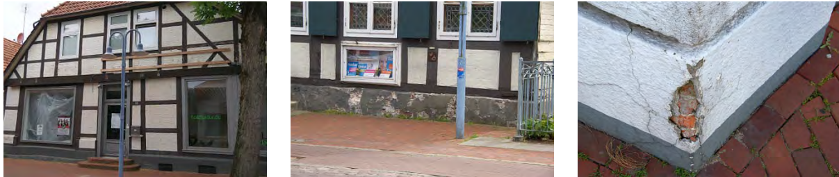
Abb. 72: Sanierungsbedarf an ortsbildprägenden Gebäuden
